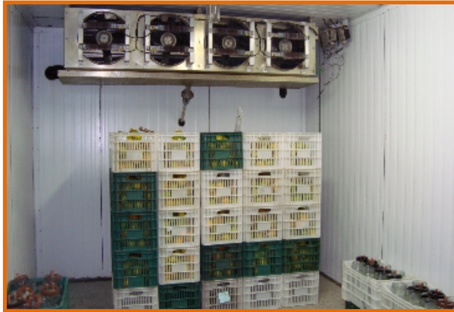
Figura 3A – Armazenamento das laranjas em câmara fria à temperatura de 21 °C.
