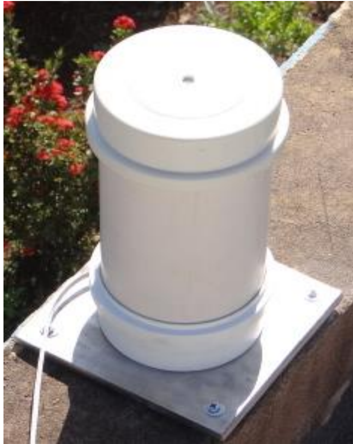
Figura 7 – Equipamento instalado sobre uma base de alumínio parafusada numa viga do telhado.
