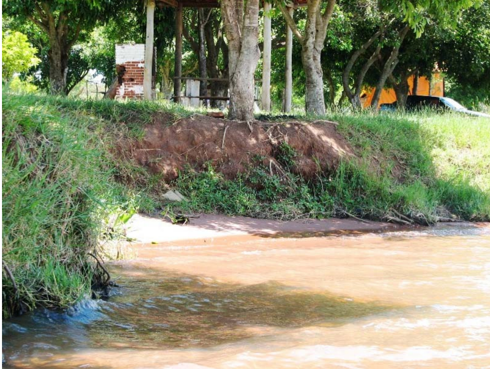
Figura 23 – Processo de erosão marginal instalado na prainha municipal. A Prefeitura e órgãos competentes estudam formas de conter a erosão. Terra Rica – PR (Toniolo, 2005).
