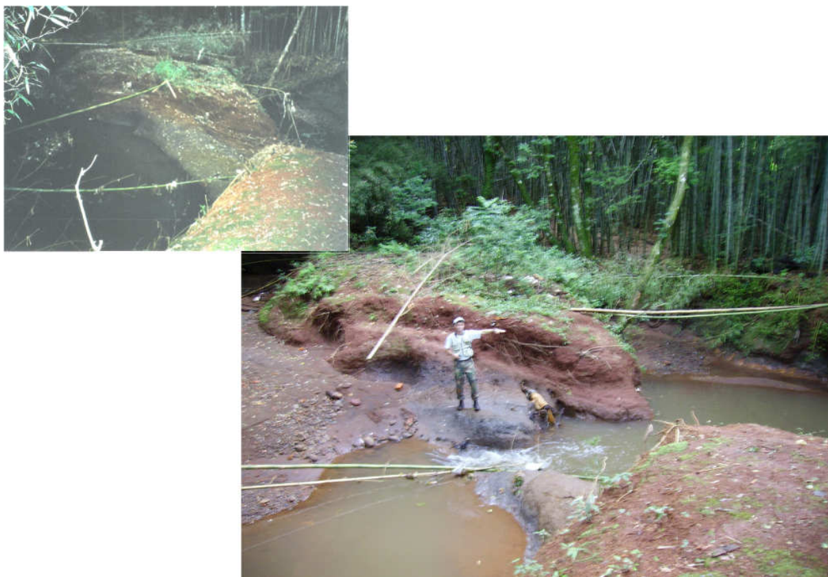
Fotos 59 e 60 - Por ser um ribeirão, cujo leito é controlado pelo substrato rochoso, possui várias curvas e, em várias delas, a força da correnteza está provocando o desmoronamento das margens, alterando em alguns pontos o curso do ribeirão Biguaçu. No caso, as águas passavam atrás do barranco, como demonstra a imagem registrada em 2005 e, em janeiro de 2007, as águas já avançam por novo caminho. Autora: Faria (2005-2007).
