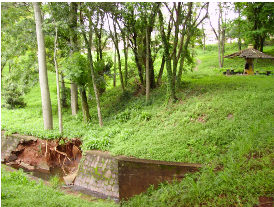
Foto 42 - A má conservação do parque é observada constantemente. Como exemplo, são as várias erosões na calha concretada e isso demonstra a falta de manutenção do parque. Em segundo plano, vê-se uma das churrasqueiras que se apresenta em situação de abandono. Autora: Faria (2006).
