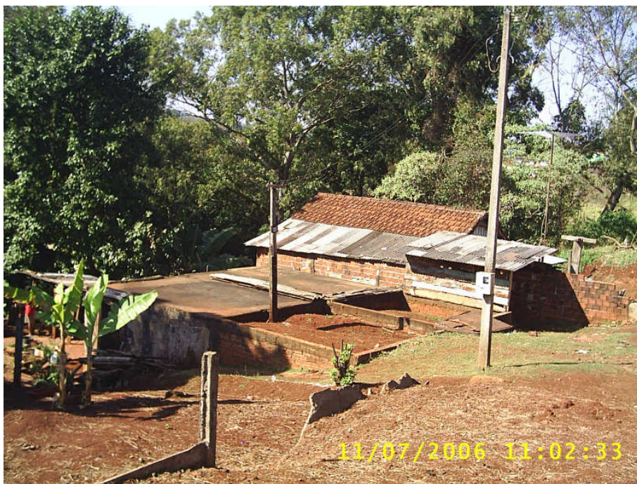
Foto 29 - Residência do Sr. José ribeiro que habita na primeira casa, sem telhado, basicamente um porão, com sinais de infiltração e umidade. Autora: Faria (2006).
