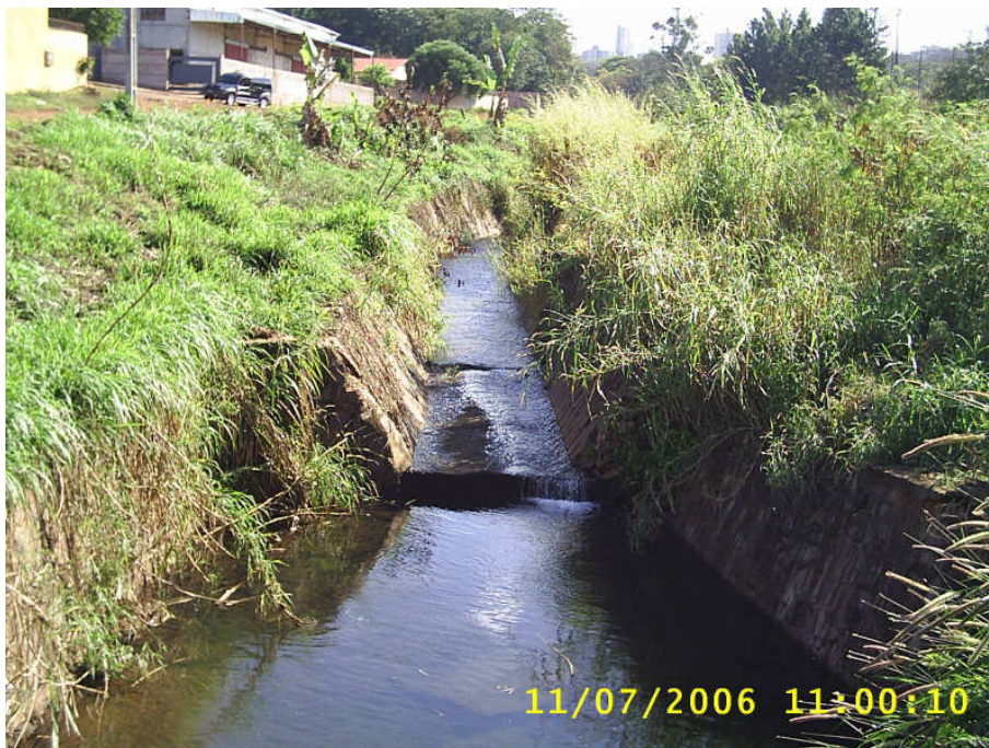
Foto 44 - No fim dos 968m de canalização do ribeirão, inicia-se o leito normal, porém, o que se observa em suas margens, até então, é a falta de mata ciliar e a área urbana adentrando a área de preservação permanente (APP). Autora: Faria (2006).
