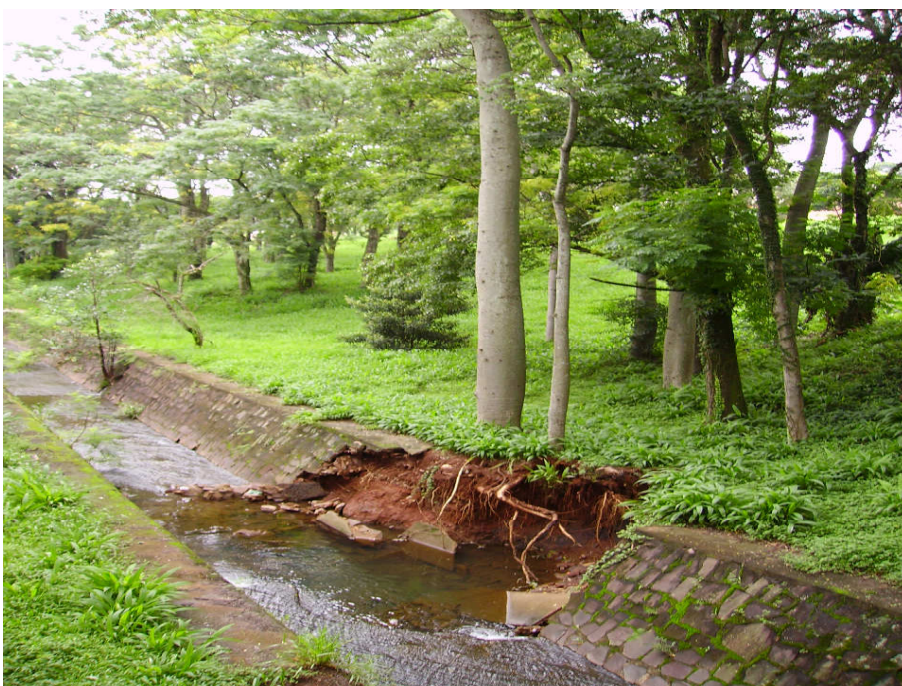
Foto 25 - Erosão da calha do ribeirão Biguaçu, no qual, em todo percurso se percebe erosões, demonstrando a quantidade de águas pluviais que adentram aos limites do ribeirão. Autora: Faria (2006).
