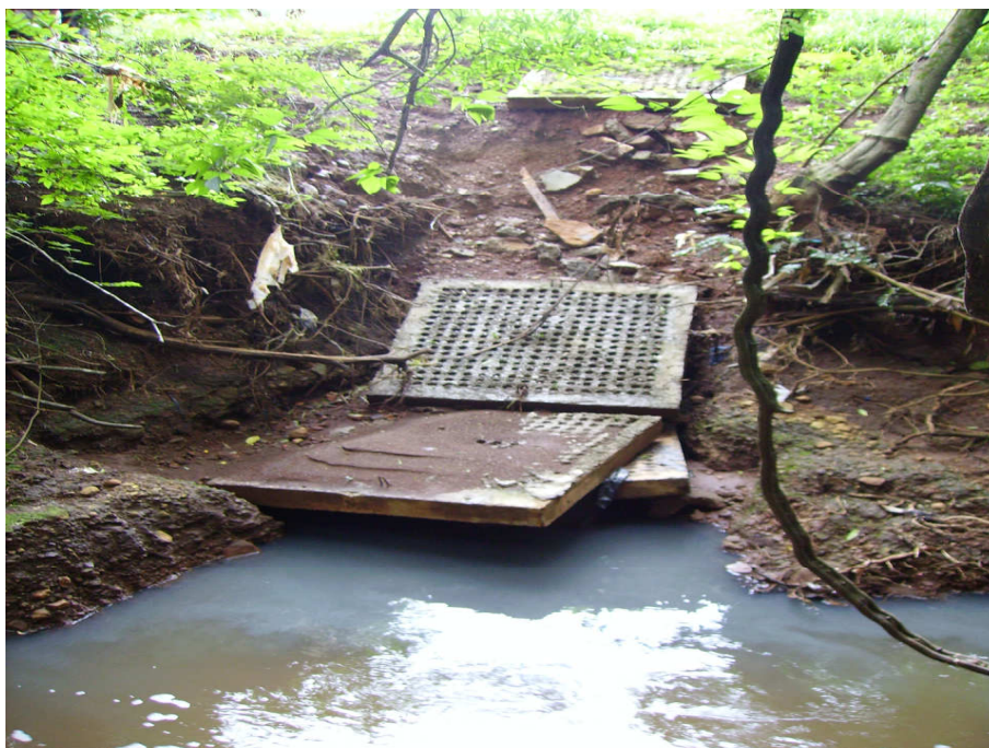
Foto 28 - Após o tratamento o efluente é jogado diretamente nas águas do ribeirão Biguaçu, a água apresenta uma cor azulada e mau cheiro. Autora: Faria (2006).
