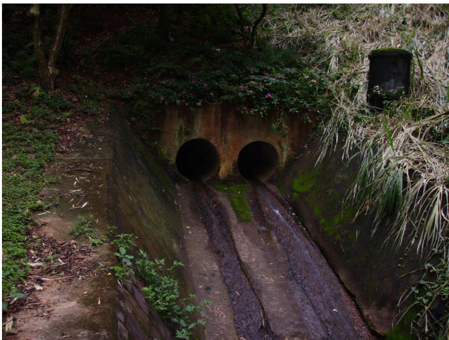
Foto 40 - 817m de altitude, em área urbanizada, se observa os primeiros indícios de água do ribeirão Biguaçu, formados por um conjunto de pequenas nascentes que, canalizadas, mostram suas primeiras águas em calha concretada no início do Parque Biguaçu.
