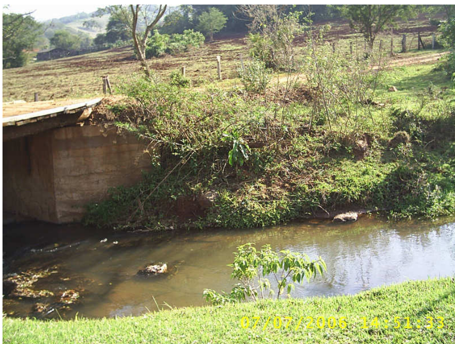
Foto 75 - Próximo à escola, há uma ponte e a estrada que, conforme a CTNP, foi planejada para passar sobre o espigão, neste ponto, está junto ao vale. Por ser uma área de desníveis, não há a presença de mata ciliar e o gado se utiliza da água, pois a cultura que predomina são as pastagens. Autora: Faria (2007).
