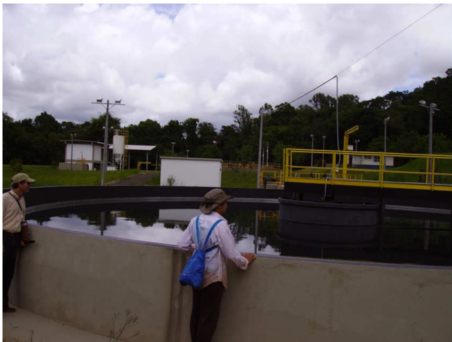
Foto 27 - ETE Biguaçu - recentemente ampliada agora com unidade de tratamento biológico (UASB) e aumentando sua capacidade de tratamento de esgoto. Autora: Faria (2006).
