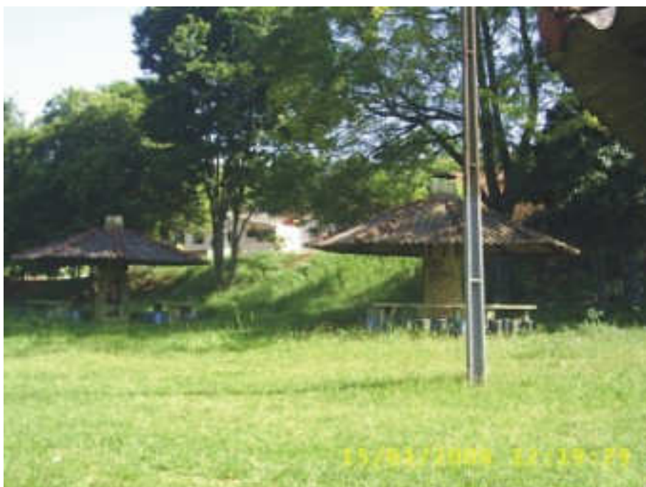
Foto 15 - Churrasqueiras do parque Biguaçu construídas para lazer da população local que se encontram deterioradas. Autora: Faria (2006).
