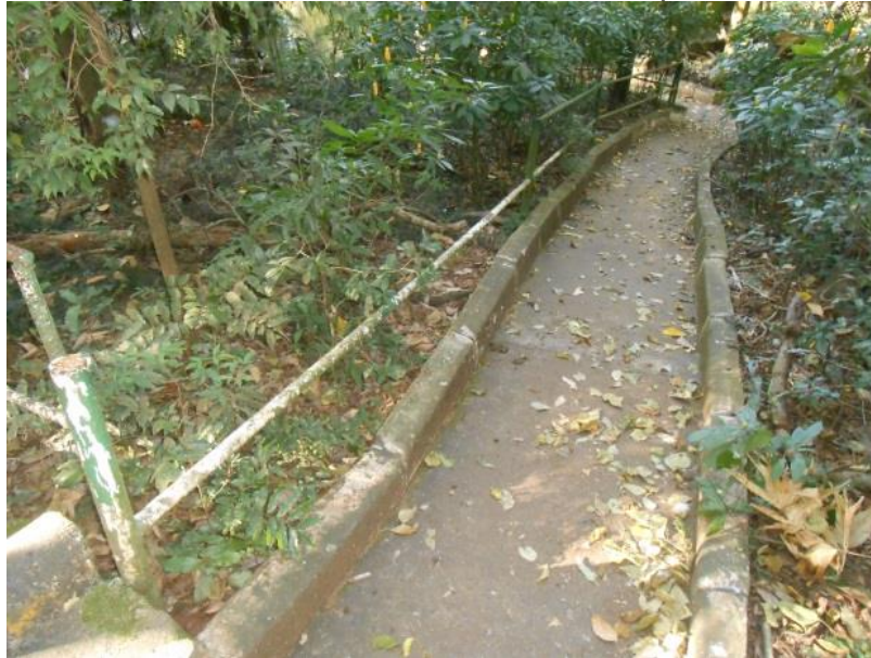
Figura 27 – Caminho com corrimão quebrado.
