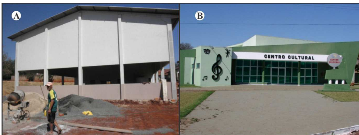
Figura 27 – A) Construção do refeitório da Escola Municipal Presidente Nédise; B) Reforma do Centro Cultural.
