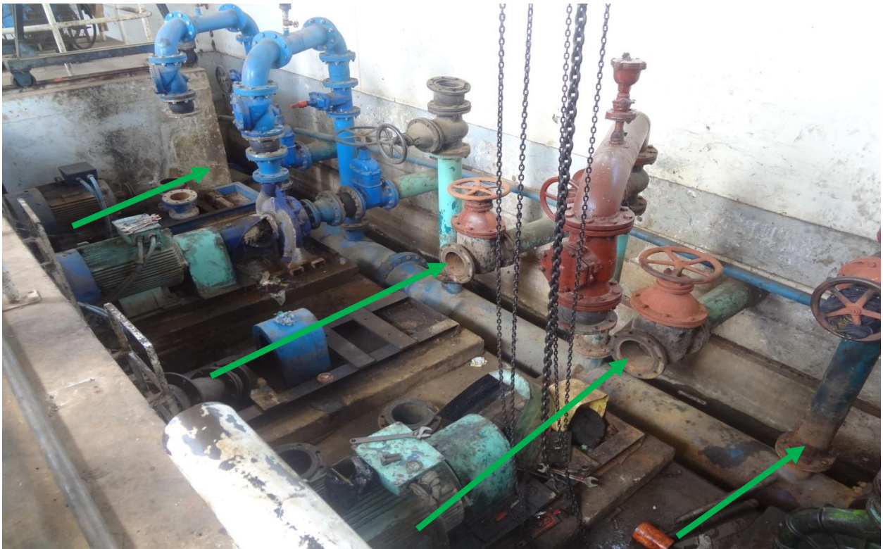
Figure 6: Estação de captação de água de irrigação de massaca com 4 motobombas avariadas há 1 ano. Fonte: Mubai (2013) – pesquisa de campo
