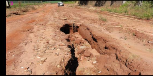
Erosões provocadas por arruamentos inacabados.
