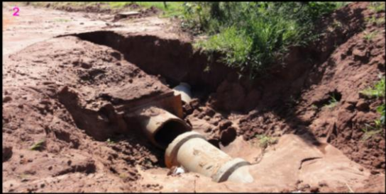
Tubulações abandonadas da área periurbana causam erosões sobre o arenito.
