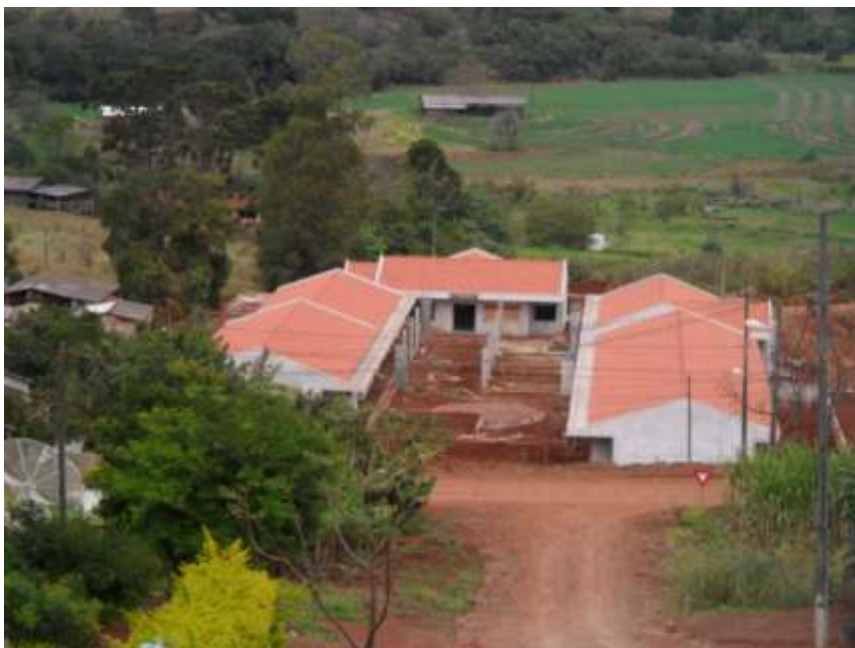
Figura 26. Nova Tebas (PR). Construção da unidade escolar de ensino infantil Fonte: Fernandes, P. H. C. – 2011
