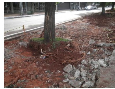
Figura 115. Vista da danificação ao sistema radicular após obras no canteiro central da Av. Brasil. Ricardo M. Albertin, 12/01/2014.
