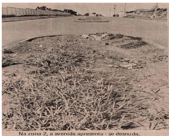
Figura 60. Vista parcial da deterioração do canteiro central da zona 02, ano de 1974.
