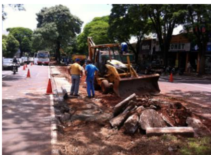
Figura 113. Execução das obras de retirada do concreto do canteiro central na Av. Brasil Fonte: Rigon (2014)
