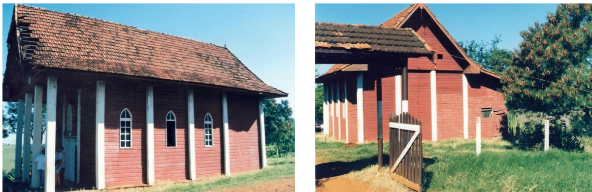
Figura 97 - Fotografia da Capela São Bonifácio degradada – lateral direita
