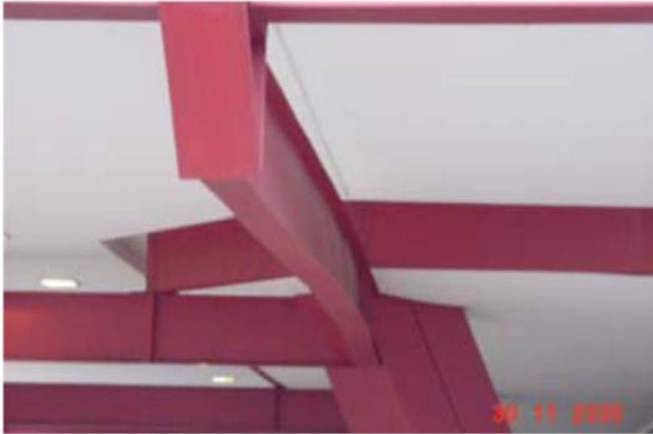
Figura 2.25 – Colapso causado por FLT em viga de um shopping no Rio de Janeiro
