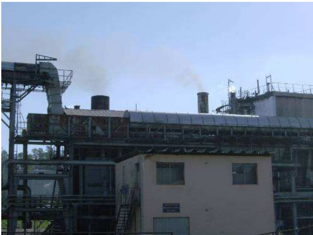
Figura 13 - Alimentador de caldeira
