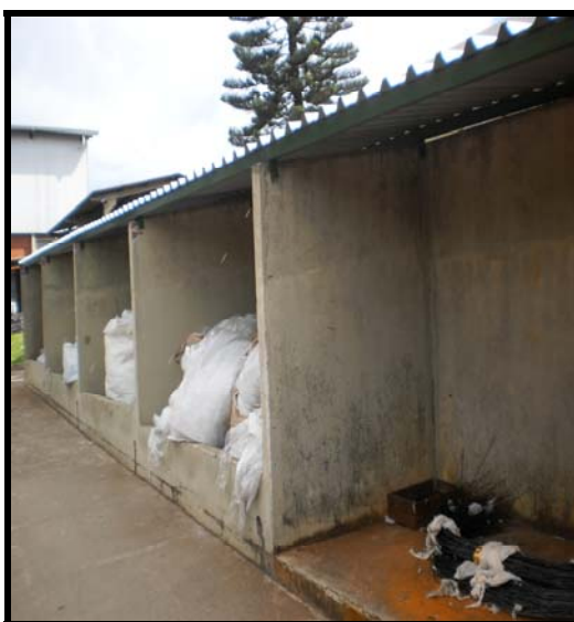
Figura 74: Local de armazenamento de resíduos sólidos da fiação X
