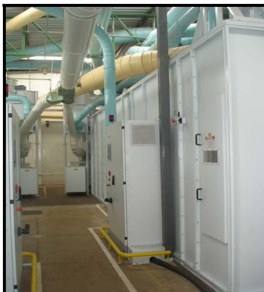
Figura 34: Sala de filtro
