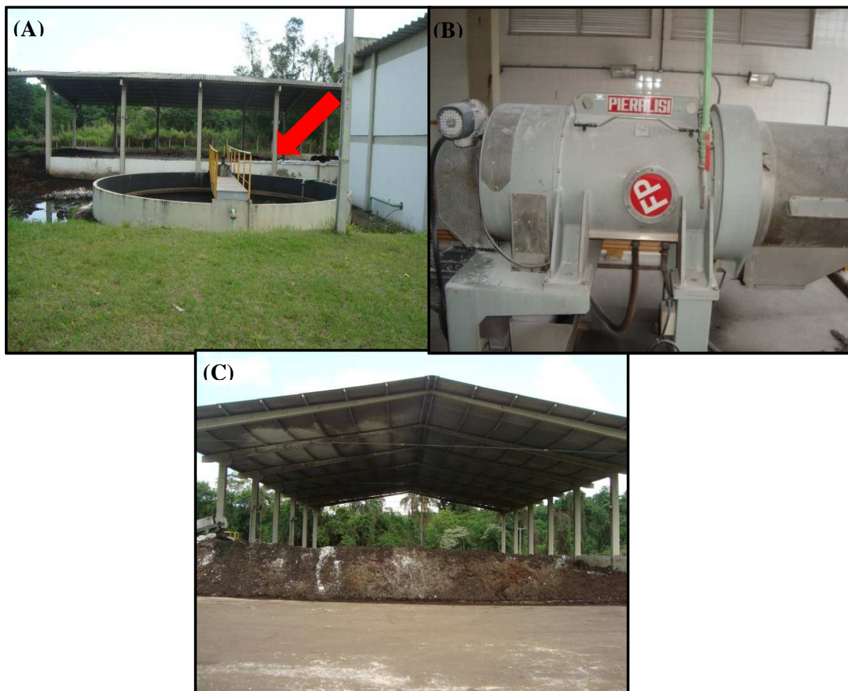
Figura 4.2- Tratamento do lodo: (A) Adensador; (B) Centrífuga de alta rotação e (C) Pátio de cura
