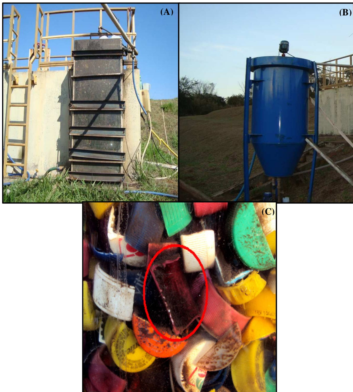
Figura 4.4- Planta Piloto: (A) Filtro biológico aerado submerso; (B) Decantador secundário e (C) Material de Enchimento Fonte: O Autor (2011)
