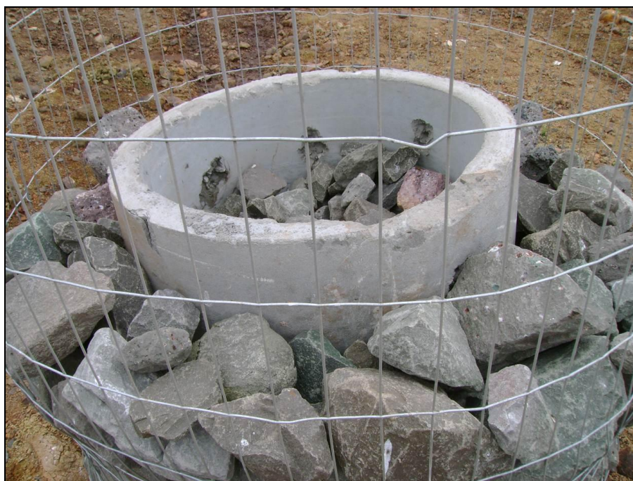
Figura 9 – Imagem dos drenos verticais de gás do aterro sanitário de Maringá-PR.
