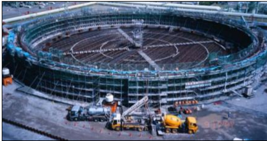
Figura 2 - Tanque para gás liquefeito em Osaka
