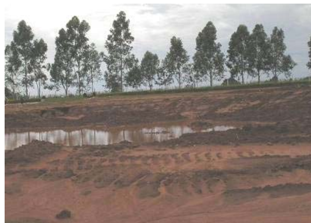
Figura 67. Vista parcial do empoçamento na parte frontal do aterro sanitário de Cianorte/PR Fonte: Albertin et al. (2009)
