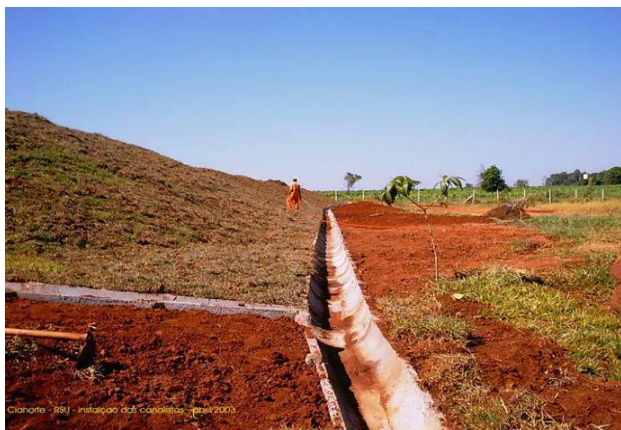
Figura 66. Sistema coletor de águas pluviais do aterro sanitário de Cianorte/PR Fonte: SANEPAR (2004) apud RAMOS (2004)
