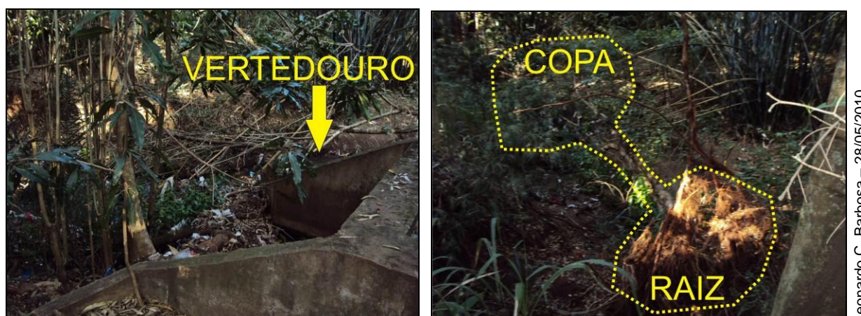
Figura 41 – Vertedouro próximo a nascente do Córrego Mandacarú e queda da árvore ao lado devido à erosão
