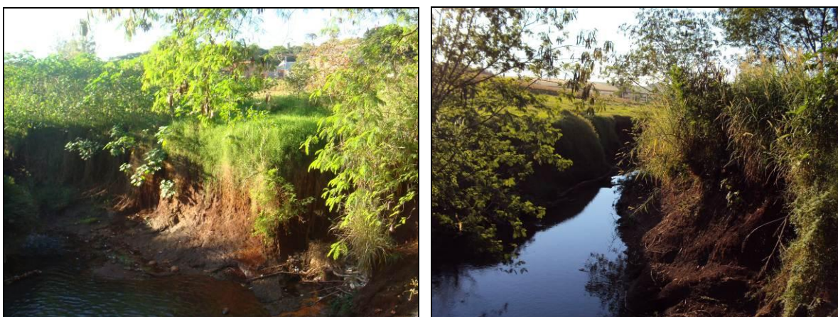
Figura 22 – Pontos de erosão marginal em local sem vegetação ripária
