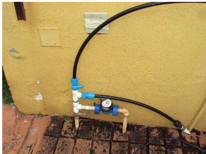
Figura 14 - Conexão do amostrador e sensor de pressão no cavalete predial
