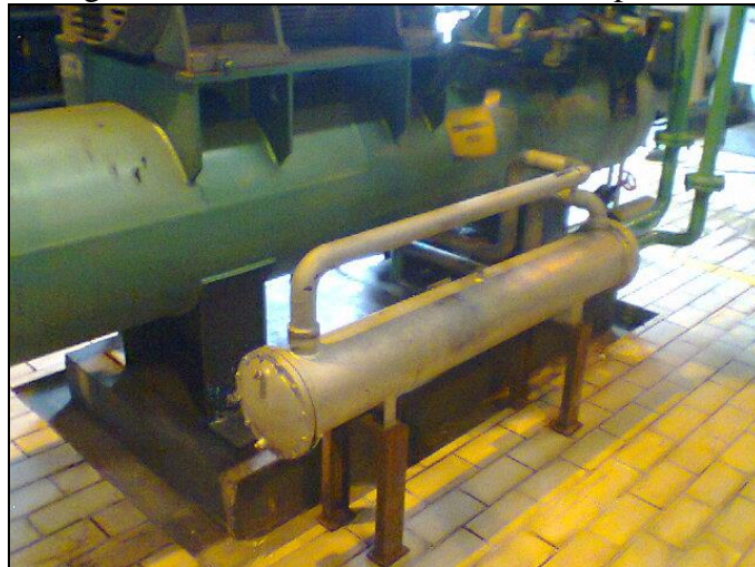
Figura 4.2 – Resfriador de óleo do compressor
