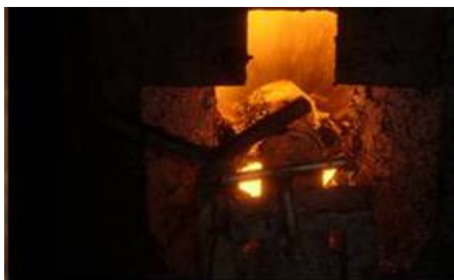
Figura 2.8: Bocal de licor em operação.
