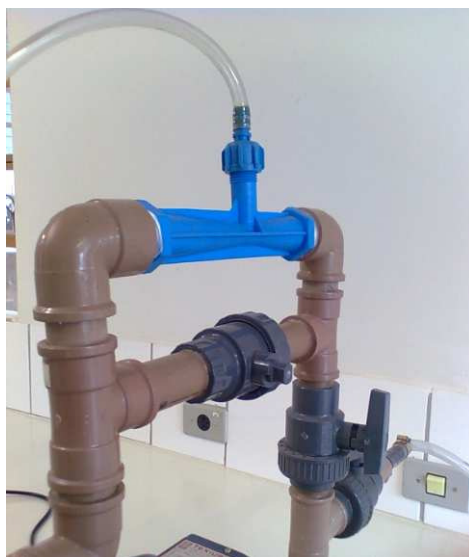
Figura 89. Detalhe da instalação do tubo venturi
