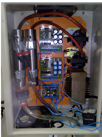
Figura 37. Detalhe interno do gerador com fonte convencional e 2 reatores
