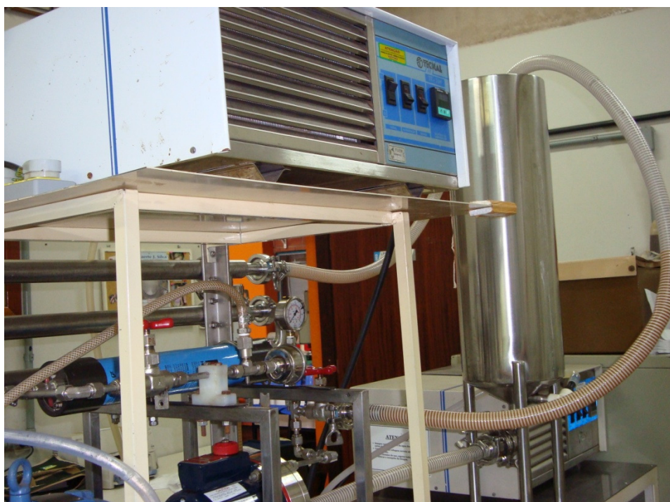
Figura 3.6: Módulo de Osmose Inversa (Vista Frontal, todo o sistema)
