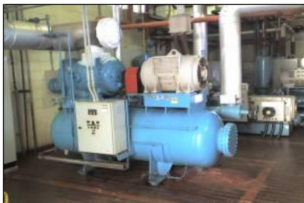
Figura IV.4 – Grupo gerador e compressor para geração de frio
