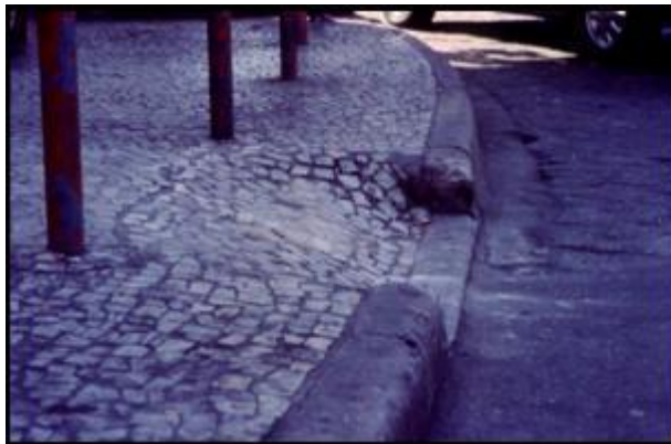
Fig. 2 - calçada da escola CEEBJA – Newton Guimarães
