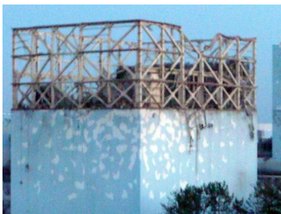
Figura 15: Edifício do reator nº 1 após a explosão ocorrida no dia 12/03/2011.
