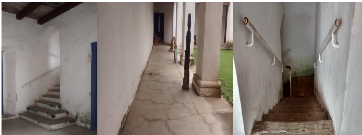
Figura 44: Sinais de ação do tempo na Igreja e Residência dos Reis Magos, Nova Almeida, 2016. Fonte: Arquivo pessoal da autora.
