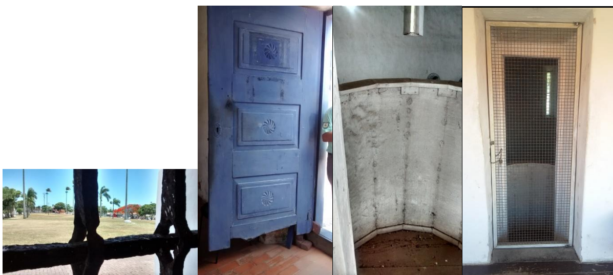
Figura 45: Grade de ferro da janela, porta e púlpito da Igreja e Residência dos Reis Magos, Nova Almeida, 2015/2016. Fonte: Arquivo pessoal da autora.
