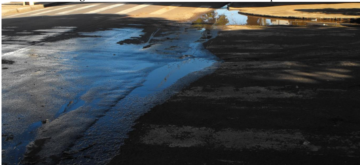
Figura 19: Turma 1 - Ponto 4 - Bocas de lobo entupidas
