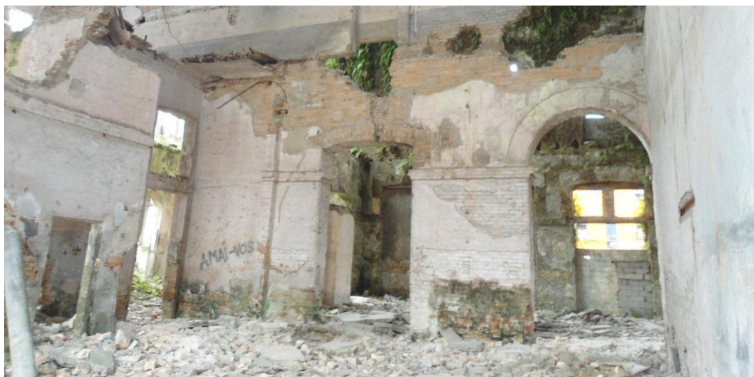
Figura 37. Condição das paredes internas da ala norte. Foto da autora, 2012.
