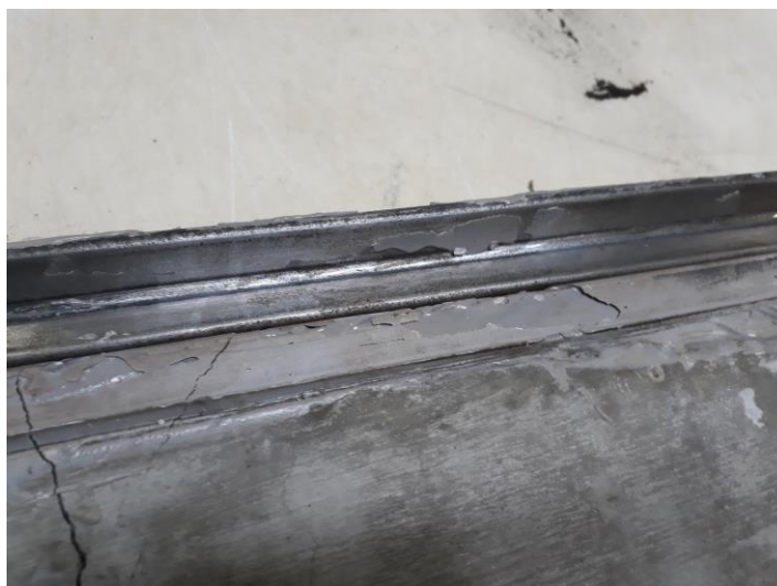
Figura 6.25 – Vazios na ligação do reforço com da Viga C1
