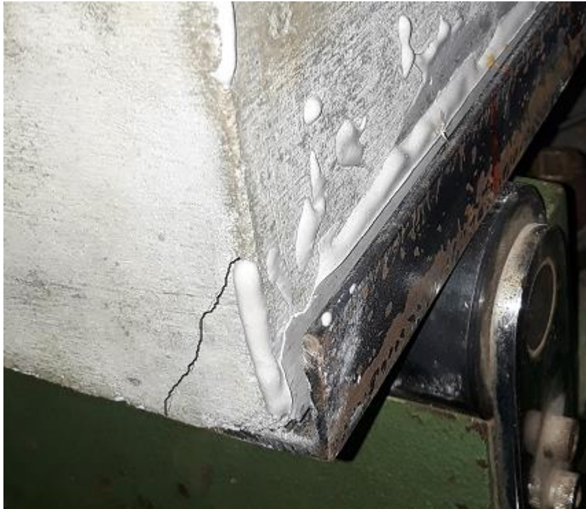
Figura 6.17 – Fissuras na extremidade do reforço da Viga B1
