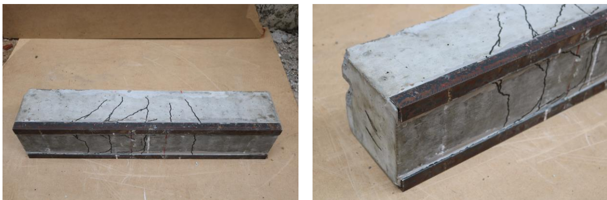
Figura 6.22 – Fissuras Viga D2
