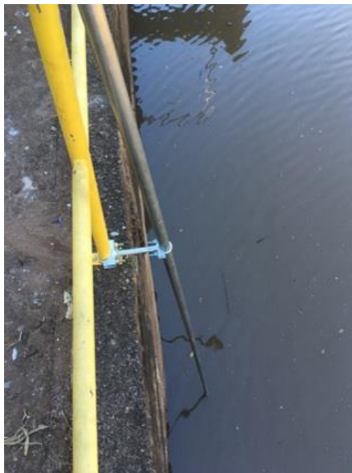
Figura 3-30 – Tubo para acondicionamento dos sensores em P2
