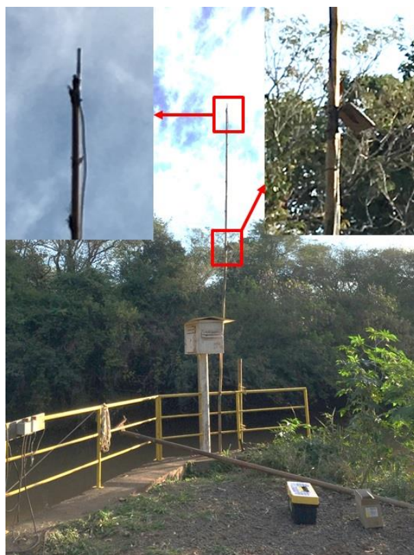
Figura 3-28 – Fixação da antena e painel solar em P1
