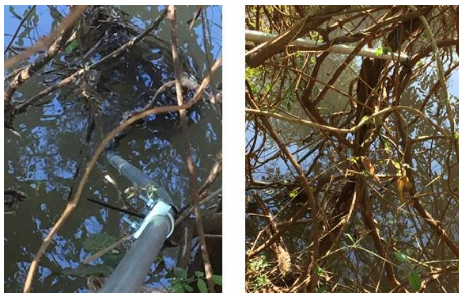
Figura 4-5 – Estado do tubo de aço galvanizado em P2
