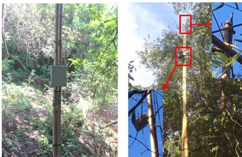
Figura 3-33 – Instalação do circuito do nó sensor em P3
