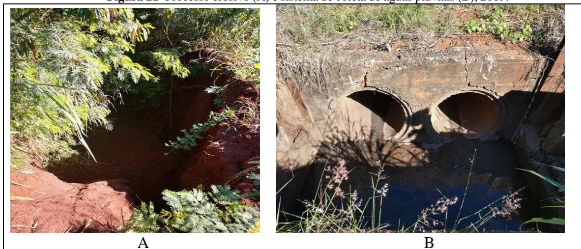
Figura 21- Processo erosivo (A) e sistema de coleta de águas pluviais (B), 2019.
