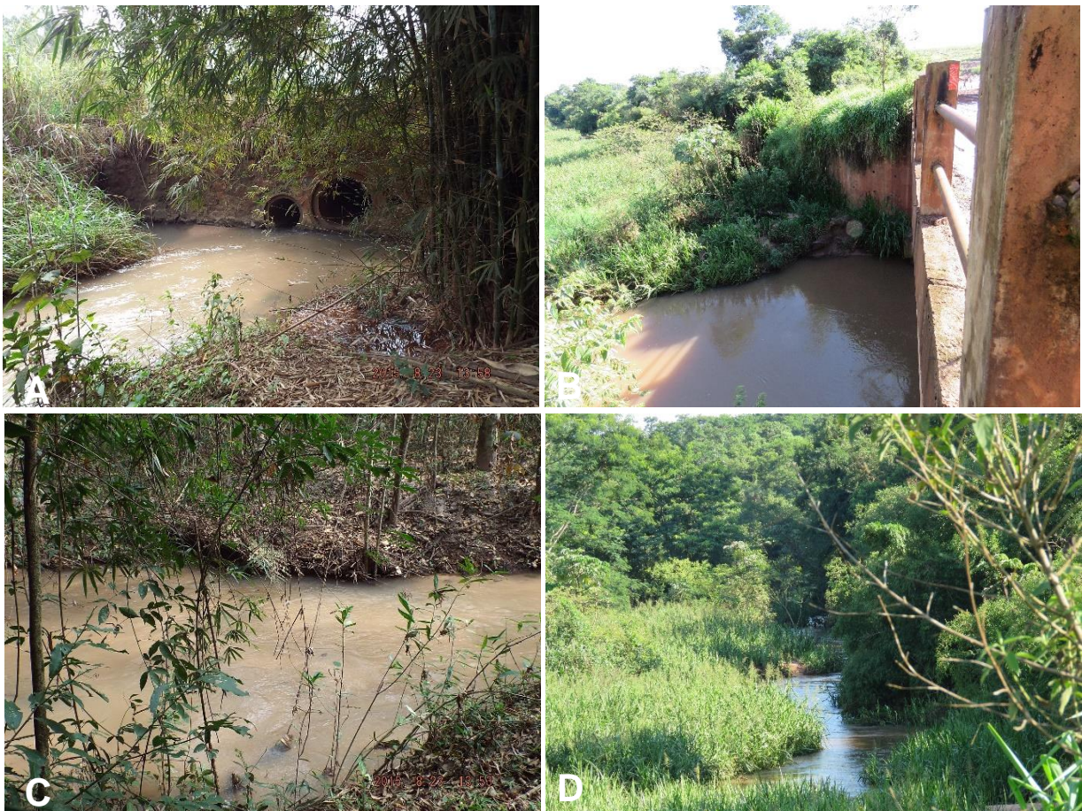
Figura 5. As imagens ilustram: A e B. Alteração do canal no rio Bolivar (tubulação impedindo o fluxo normal) e no Índios (ponte). Estabilidade dos barrancos: C. Bolivar; D. Índios.
