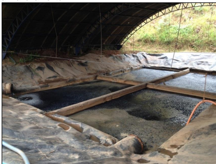
Figura 8 – Local de Coleta de lixiviado - Tanque de armazenamento.
