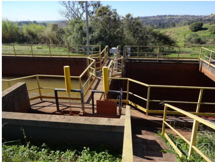
Figura 9 – Tanques de armazenamento do lodo após etapa de decantação
