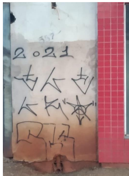
Figura 18: Pichação em parede
