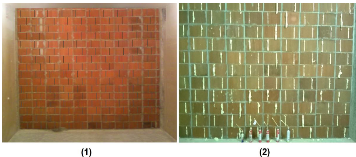
Figura 3.23 - Parede de blocos acústicos. Ressonadores sem preenchimento (1), ressonadores com preenchimento (2)
