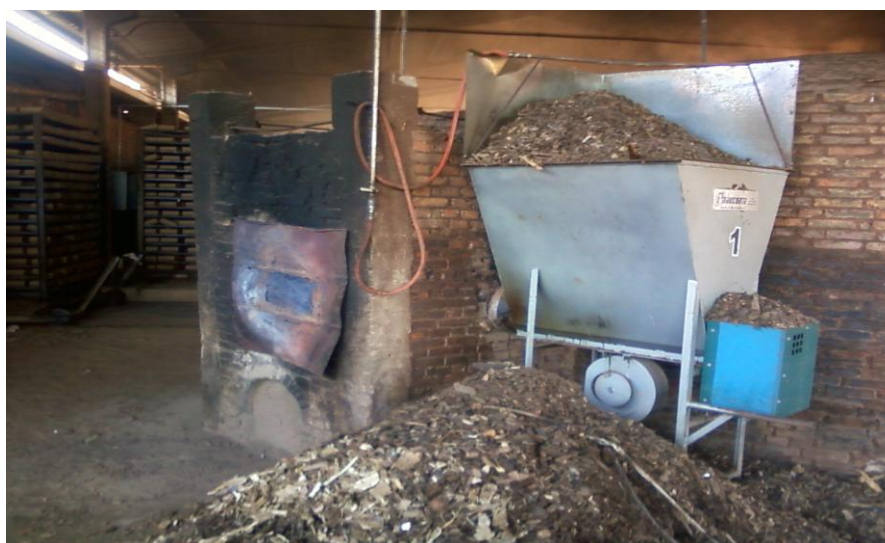
Figura 3.24 - Dosador mecânico de cavaco de madeira do forno
