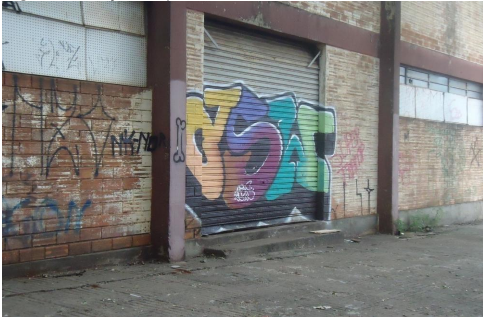
Figura 21 – Pixações em prédio abandonado
