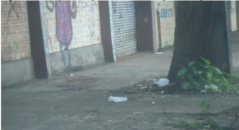
Figura 11 – Exemplo de calçada em má conservação no campo estudado
