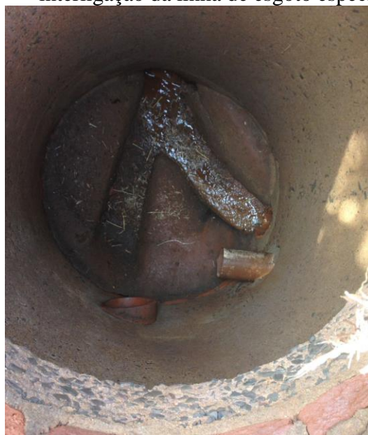
Figura 13 – PV 14: Identificação física da interligação da linha de esgoto especial
