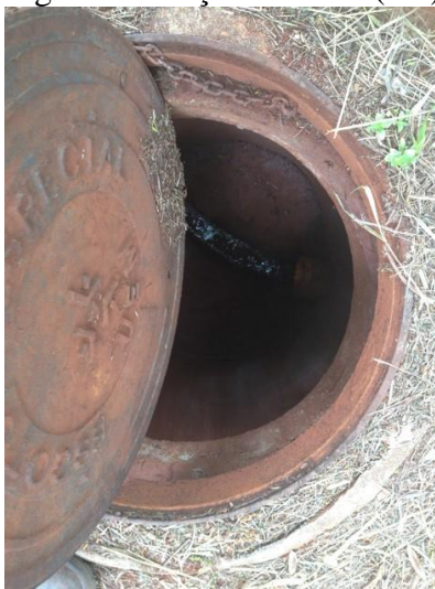
Figura 5 – Poço de Visita (PV)
