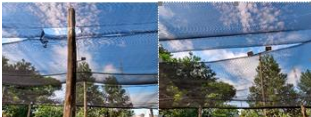
Figura 9 Telas de sombreamentos avariadas.
