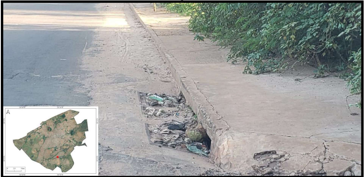
Figura 29: Boca-de-lobo obstruída pelo acúmulo de resíduos sólidos, sedimentos e folhagens
