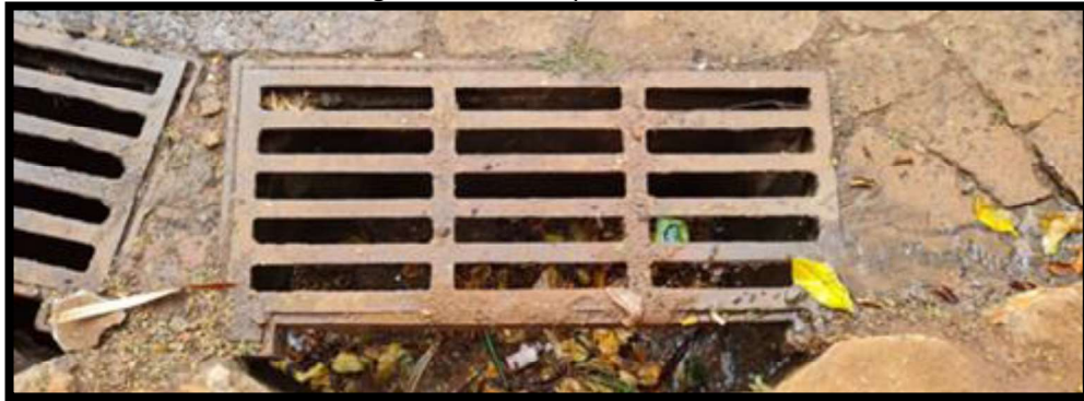
Figura 43: Acúmulo de folhagens, sedimentos e resíduo sólido em um ponto de ocorrência de alagamento Campo Grande – MS.
