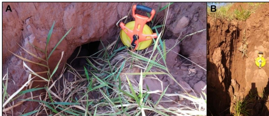
Legenda: (A) Dutos de pipe ; (B) Alcovas de regressão e solapamento do solo. Fotografias: Samuel Matiazo (12/10/2017)
