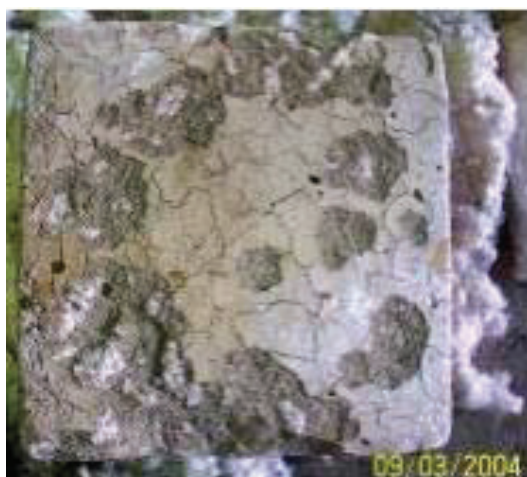
Figura 1.1 – Exemplo de lascamento do concreto
