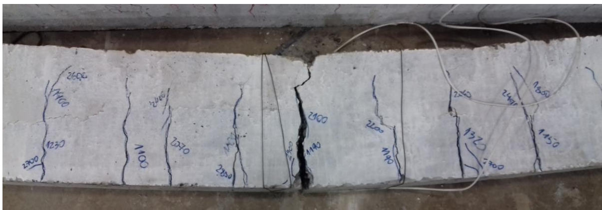
Figura 63 – Fissuras – Viga VFR
