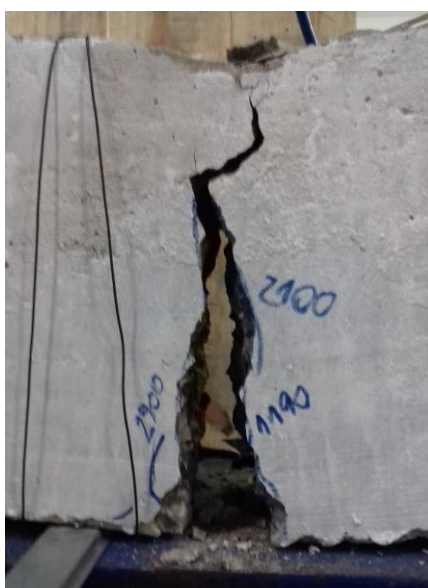
Figura 62 – Ruptura da armadura tracionada – Viga VFR
