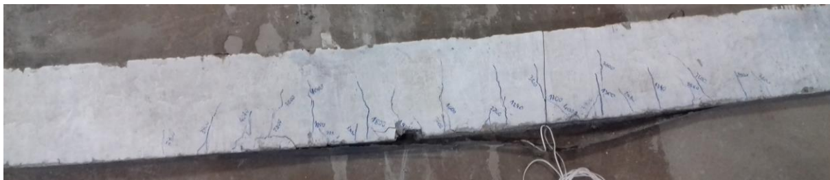
Figura 75 – Fissuras – Viga VF3
