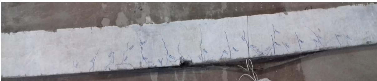
Figura 72 – Fissuras – Viga VF2
