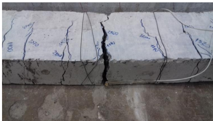
Figura 53 – Marcação das fissuras
